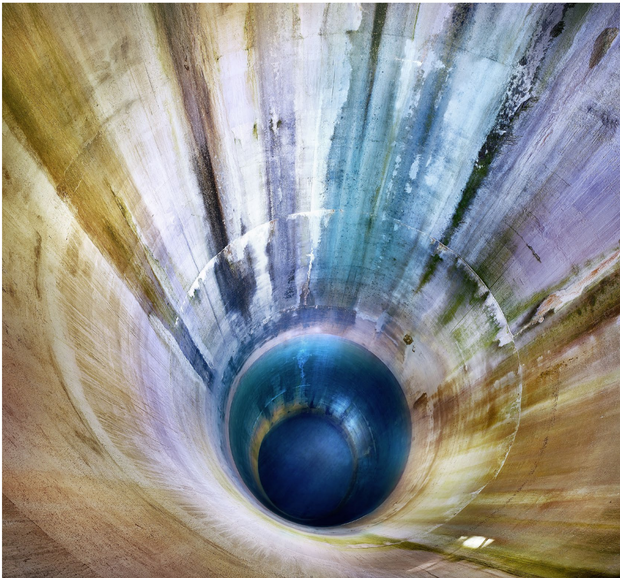
Und irgendwo da unten fliesst das Wasser: Blick in den Entlastungsschacht des Zulaufstollens in der Stauanlage Valle di Lei. Sie liegt 1931 Meter über dem Meer und ist das Herzstück der grössten Kraftwerkskombination im Kanton Graubünden. Die Staumauer ist 138 Meter hoch und 600 Meter lang. Der Stausee, der fast vollständig auf italienischem Boden liegt, fasst eine Wassermenge von rund 200 Millionen Kubikmetern.
